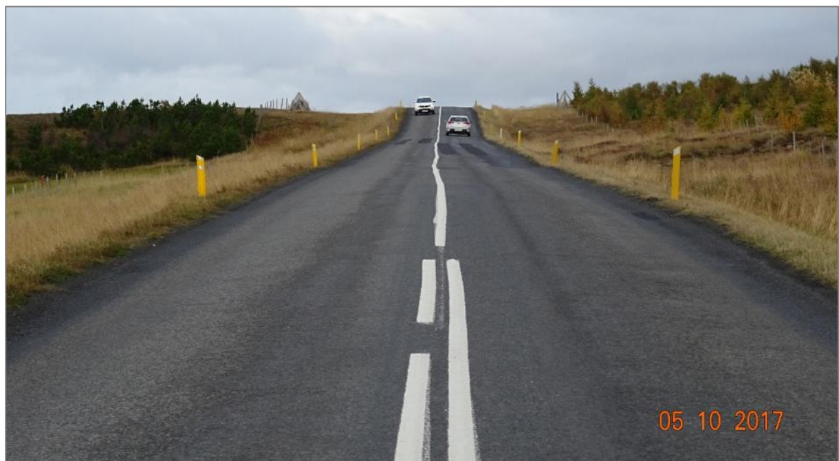
Mynd 2.2.7. Blindhæð á núverandi Skagastrandarvegi. Á blindhæðinni má sjá prílur yfir girðingar beggja vegna vegarins (ljósmynd: Sóley Jónasdóttir).
