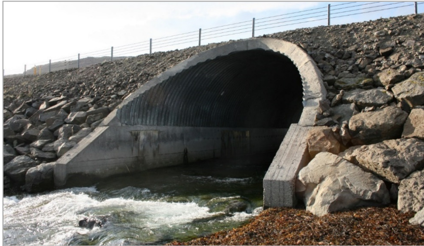
Mynd 6.7.3. Þverá í Vatnsfirði, stálræsi með steiptum undirstöðum og hálfhring yst (mynd: Aron Bjarnason, 2014).
